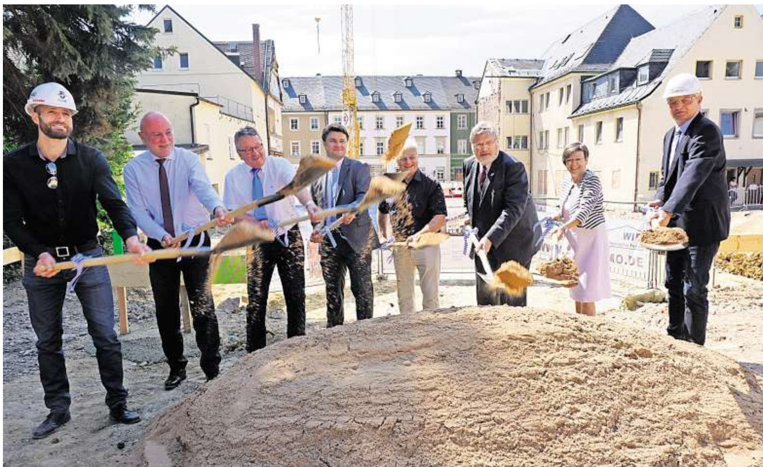
Reichlich Sand haben die Ehrengäste beim Spatenstich bewegt (von links): Bauleiter Johannes Klose vom Architekturbüro Kuchenreuther, Hans Blüml vom Sparkassenvorstand, stellvertretender Landrat Roland Schöffel, Sparkassenvorstandsvorsitzender Andreas Pöhlmann, Werner Weiß vom Bauunternehmen Roth, Bürgermeister Karl-Willi Beck, Regierungspräsidentin Heidrun Piwernetz und der Vorstand des Kommunalunternehmens Wun-Immobilien, Uwe Heidel.
